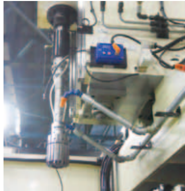
研削工程設備
