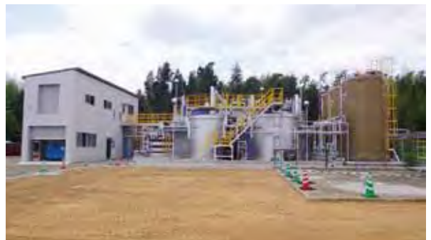
排水処理設備
