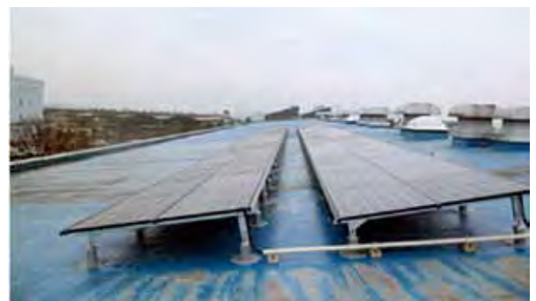
太陽光パネル
