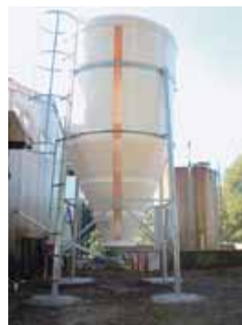
バイオマス燃料タンク
