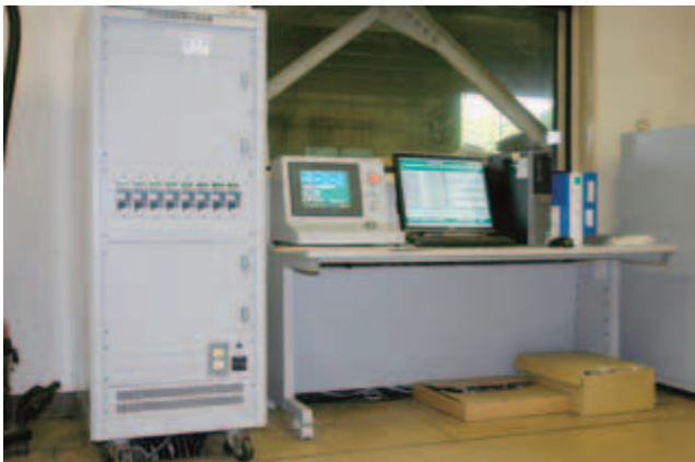
運転計測制御盤
