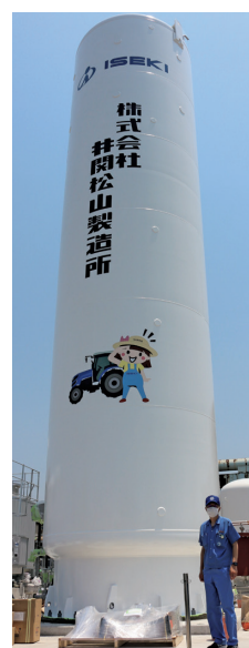
LNGタンク (容量80KL、高さ15m)
