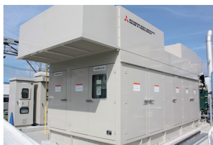
ガスエンジン発電設備
