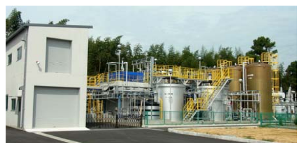
排水処理設備
