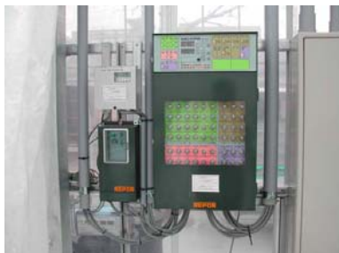
複合環境制御装置
